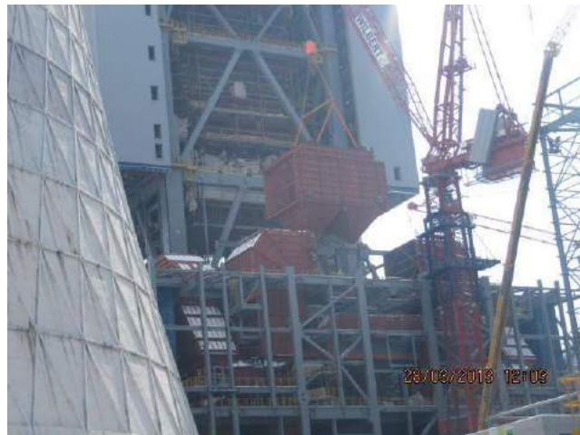
Dimovodni kanali / Flue Gas Ducts / Rauchgas Kanäle / Thermalpowerplant Šoštanj Unit 6 (SLOVENIA/ SLOVENIEN)
