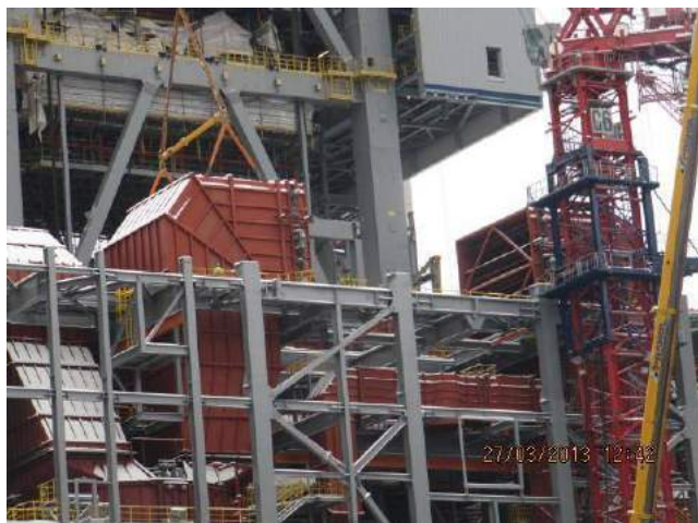
Dimovodni kanali / Flue Gas Ducts / Rauchgas Kanäle / Thermalpowerplant Šoštanj Unit 6 (SLOVENIA/ SLOVENIEN)
