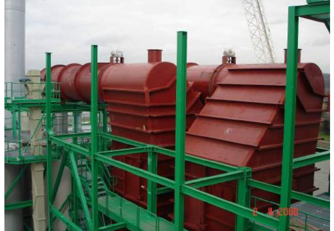
Spalionica smeća / Incineration plant / Müllverbrennungsanlage / (Intradel) - BELGIJA / BELGIUM / BELGIEN
